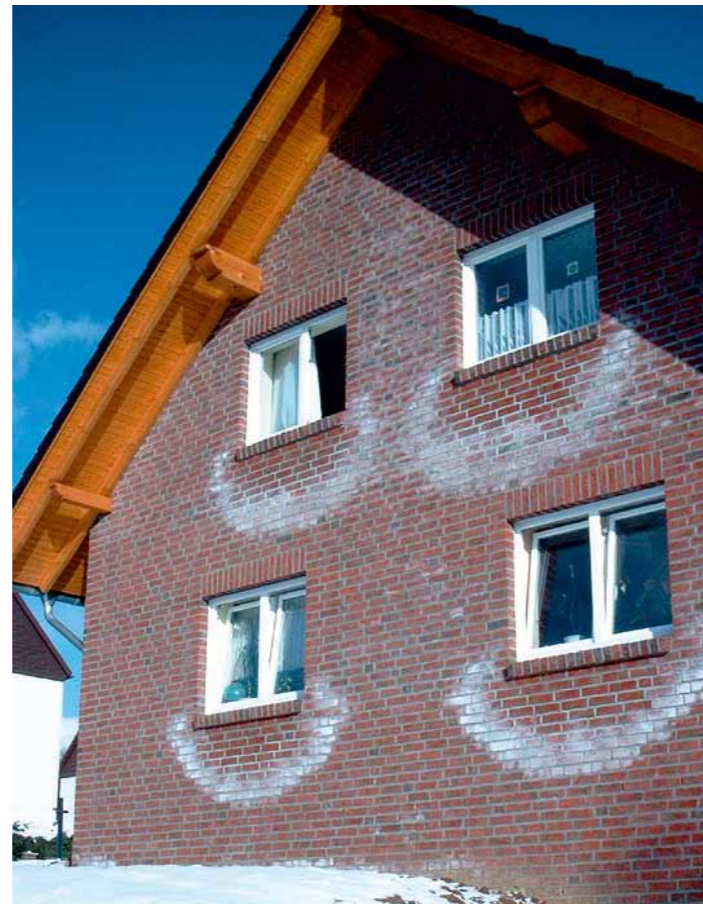
Wykwity (tu na zdjęciu tak zwane „worki na wodę”), spowodowane przez wodę deszczową, która przeniknęła do muru przez konwencjonalnie murowane parapety okienne.
